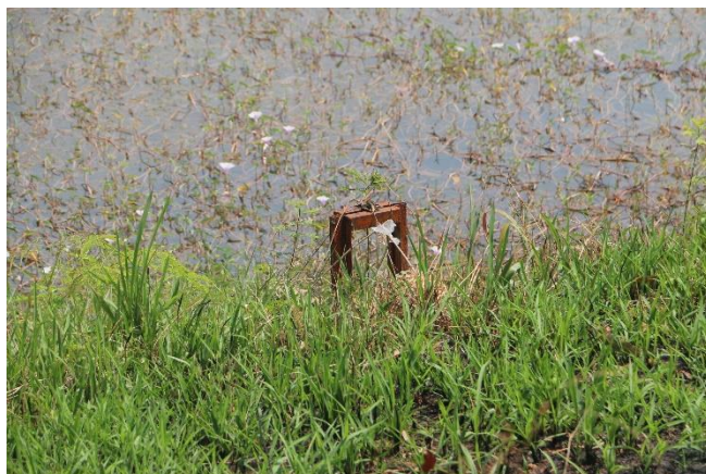
ภาพที่ 1.13.3 ประตูเปิด-ปิดน้ำ หนองกุดโคลน สภาพชำรุดใช้งานไม่ได้
