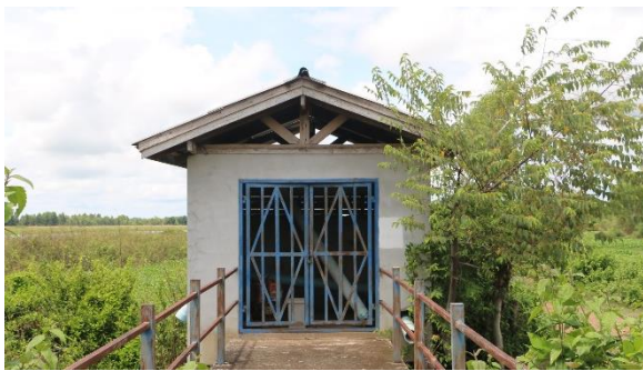
ภาพที่ 1.2.3 มีสถานีสูบน้ำด้วยน้ำมัน แต่สภาพใช้งานไม่ได้
