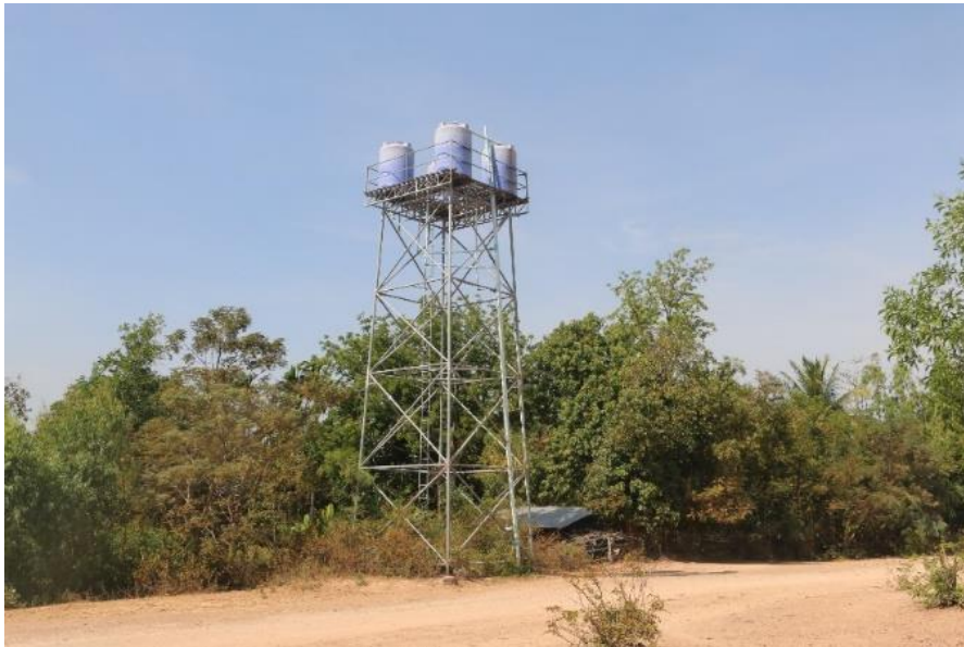
ภาพที่ 1.9.3-1.9.4 ภาพระบบประปาชุมชนหนองจรโลง ตำบลลำดวน อำเภอกระสัง จังหวัดบุรีรัมย์
