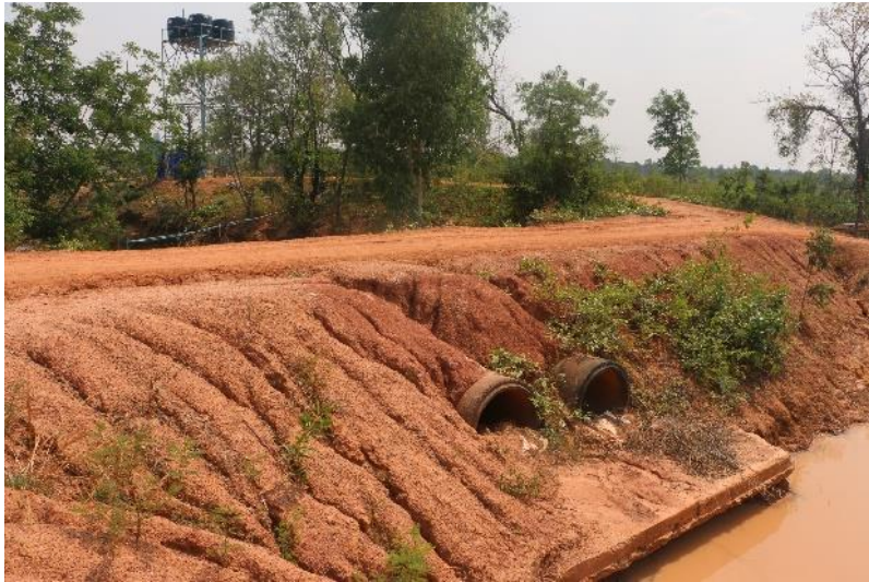
ภาพที่ 5.5.2 มีท่อส่งน้ำ เพื่อปล่อยน้ำออกไปยังหนองแดง
