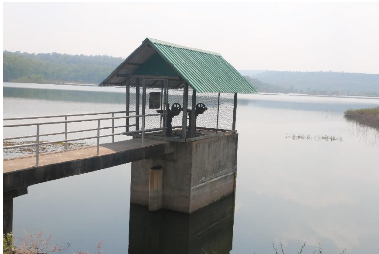
ภาพที่ 6.5.2 อาคารบังคับน้ำ อ่างเก็บน้ำคลองมะนาว
