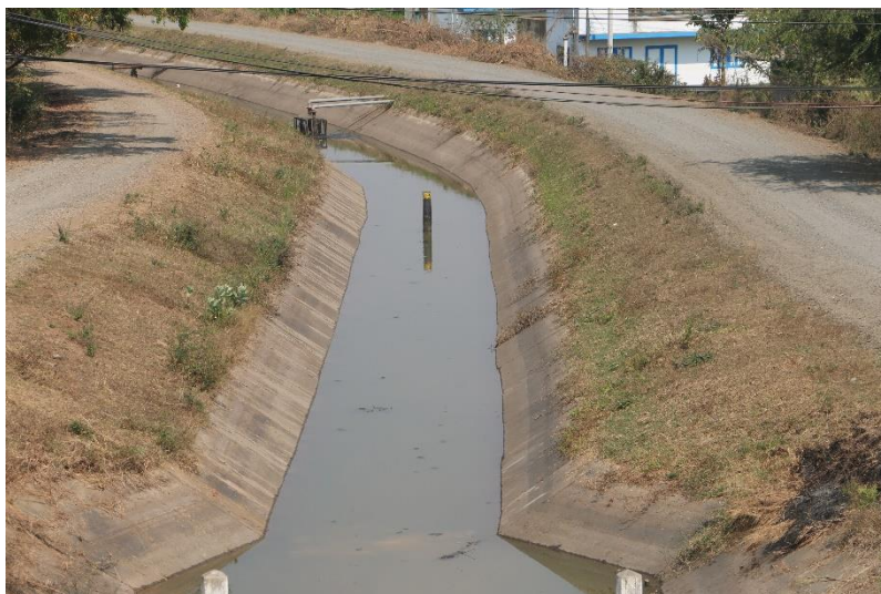
ภาพที่ 6.5.3 คลองส่งน้ำคอนกรีตเสริมเหล็กของอ่างเก็บน้ำคลองมะนาว
