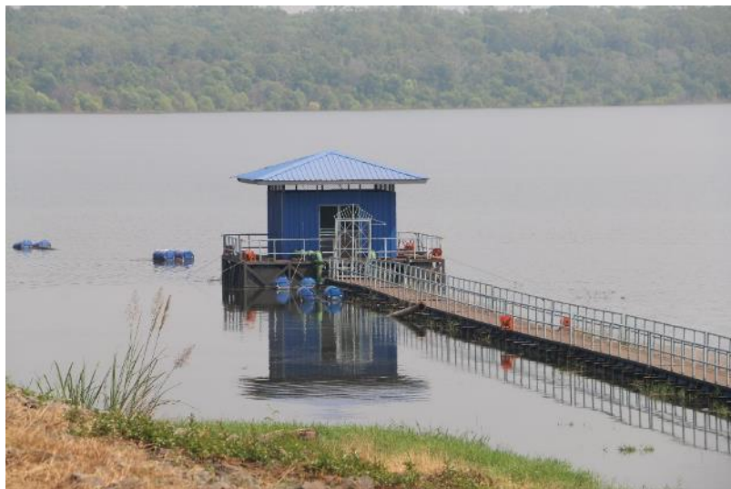
ภาพที่ 6.6.3 สถานีสูบน้ำเขื่อนลำนางรอน
