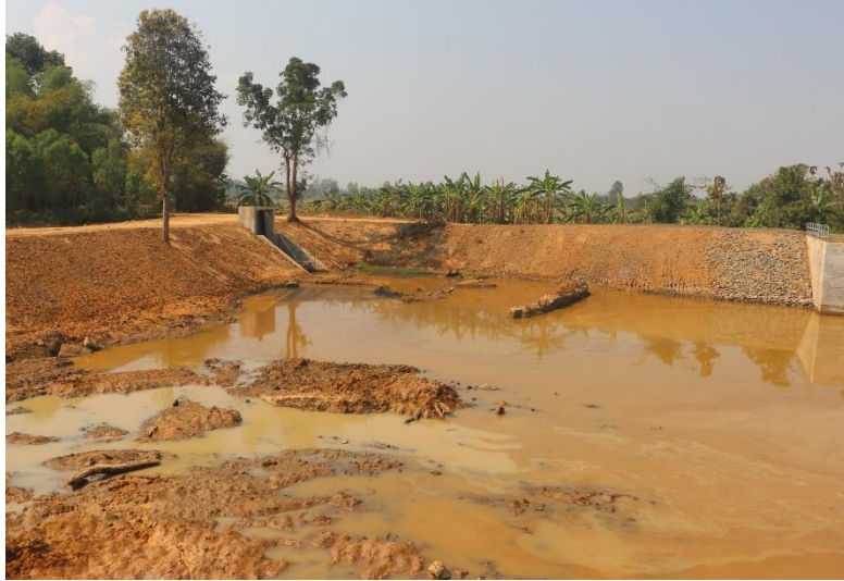
ภาพที่ 6.9.1 ฝ่ายบ้านฝรั่ง อยู่ระหว่างการดำเนินการก่อสร้างปรับปรุงฝาย
