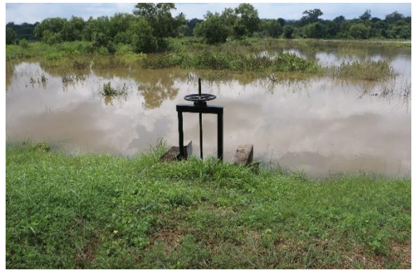
ภาพที่ 6.14.6 ประตูเปิด-ปิดน้ำ อ่างเก็บน้ำคลองยาง
