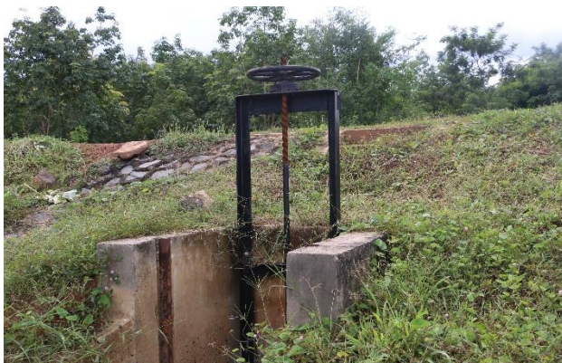
ภาพที่ 6.15.5 ประตูเปิด-ปิดน้ำ อ่างเก็บ น้ำระหอกเกต
