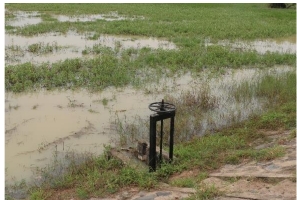
ภาพที่ 6.16.6 ประตูเปิด-ปิดน้ำ อ่างเก็บน้ำ บ้านฐานเจ้าป่า
