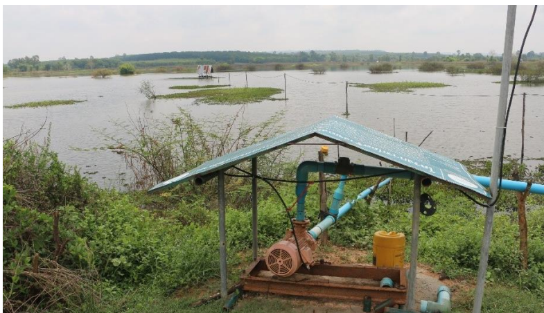
ภาพที่ 7.5.3 เครื่องสูบน้ำจากอ่างเก็บน้ำหนองไม้งาม
