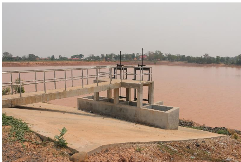
ภาพที่ 12.1.3 มีประตูเปิด-ปิดน้ำ สภาพใช้งานได้ปกติ
