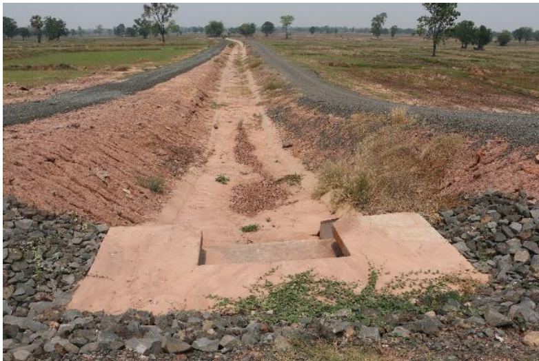
ภาพที่ 12.1.5 มีคลองส่งน้ำคอนกรีตเสริมเหล็ก สภาพใช้งานได้ แต่มีดินจากบริเวณโดยรอบทับถมอยู่บริเวณ คสล.
