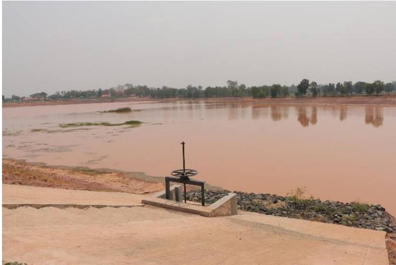
ภาพที่ 12.1.4 มีประตูเปิด-ปิดน้ำ สภาพใช้งานได้ปกติ
