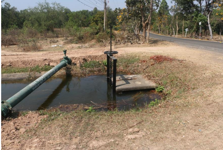
ภาพที่ 13.9.7 ประตูเปิด - ปิดน้ำ อ่างเก็บน้ำลำปะเทีย
