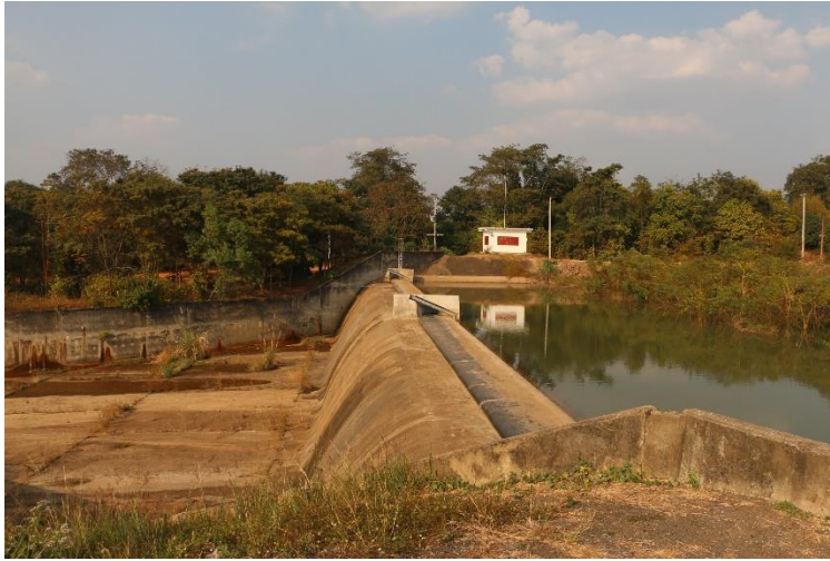
ภาพที่ 13.9.4 ฝ่ายน้ำล้น และสถานีสูบ อ่างเก็บน้ำลำปะเทีย
