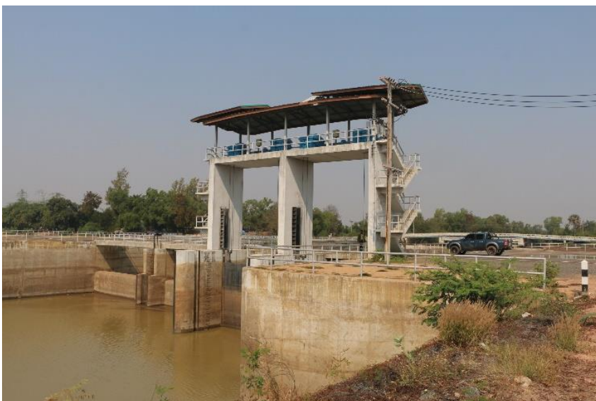
ภาพที่ 14.6.1-14.6.3 อาคารบังคับน้ำบ้านแทนพระ สภาพใช้งานได้ปกติ
