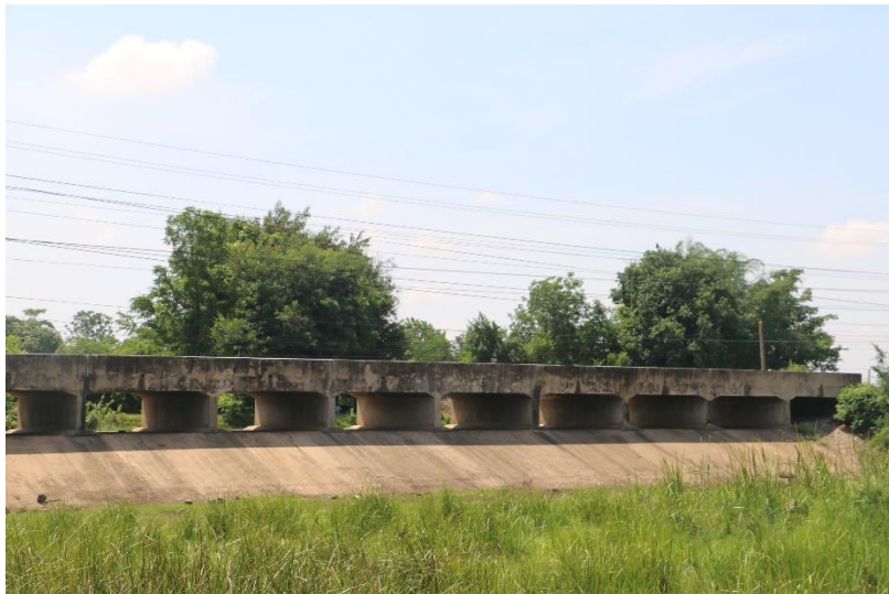
ภาพที่ 16.1.2 ฝ่ายบ้านโคกเหล็ก มีลักษณะเป็นฝ่าย คสล. ได้สะพาน
