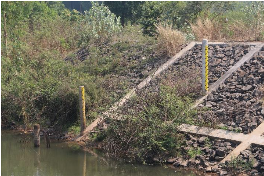
ภาพที่ 14.5.4-14.5.6 ระดับน้ำในบริเวณอาคารระบายน้ำฝายบ้านหนองโดน มีปริมาณน้อย
