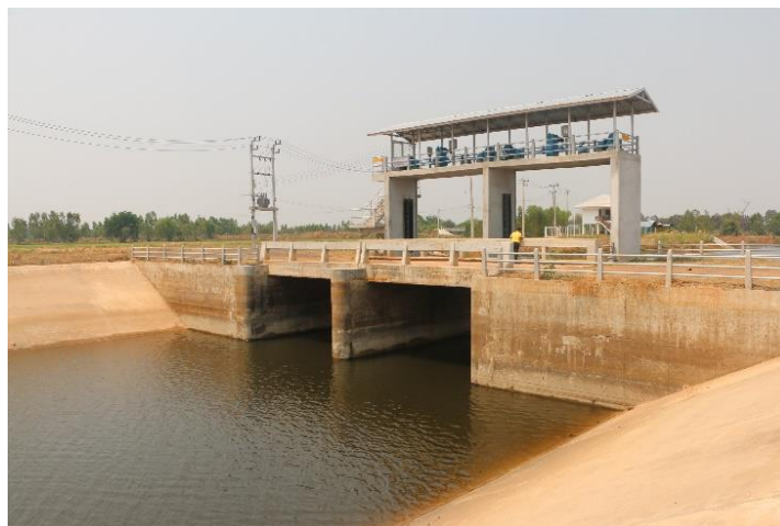
ภาพที่ 8.1.5 อาคารระบายน้ำ พร้อมคลองส่งน้ำ สภาพใช้งานได้
